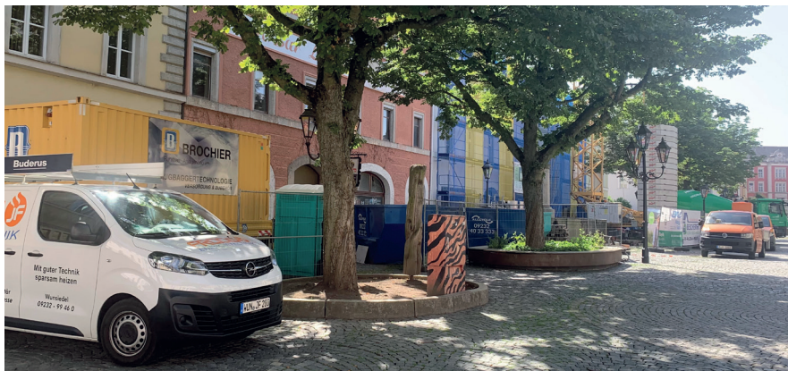
So sah es einmal aus: Eine einzige Baustelle war die Ostseite des Wunsiedler Markplatzes. Foto: Stadt Wunsiedel
