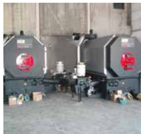
Ab Juni sollen die Heizkessel Wärme produzieren.
